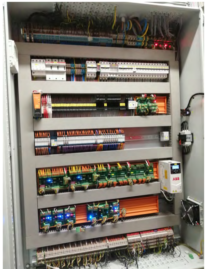
Hőszivattyús rendszer automatika-szekrénye
